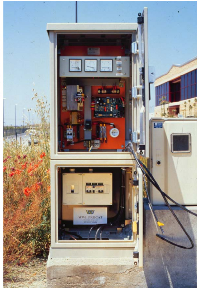
Transfo - rectificador en armario de poliéster de intemperie.
